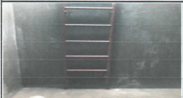
ESCALERA MARINERA PARA INGRESO AL TANQUE DE RESERVA
