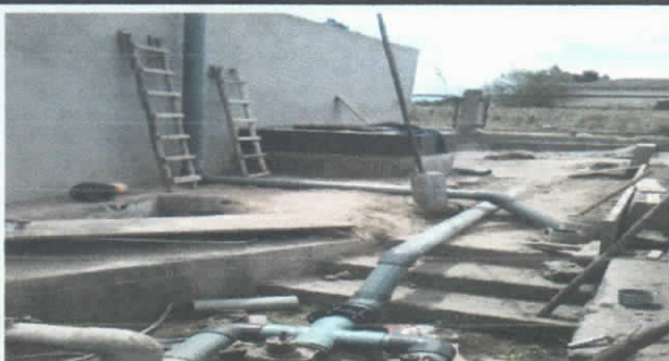
ACCESORIOS DEL TANQUE DE RESERVA
