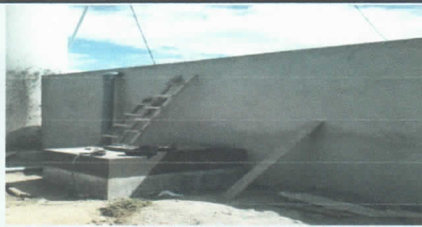
TANQUE DE RESERVA
