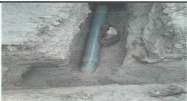
TUBERIA DE PVC DE 160MM PARA LA ALIMENTACION AL TANQUE DE RESERVA
