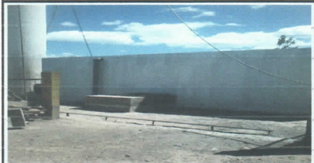
TANQUE DE RESERVA + CAJA VALVULA DE SALIDA A LA RED
