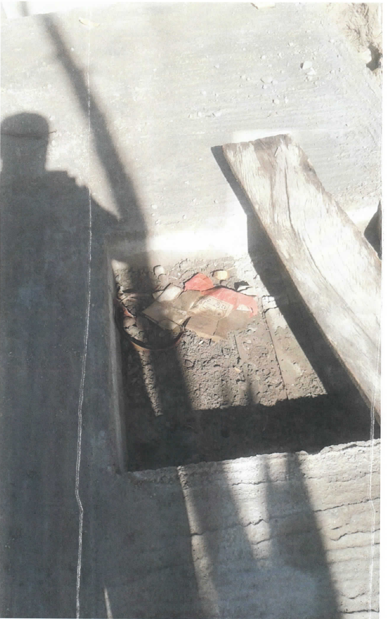
FOTOGRAFIA 1. TANQUE PEQUEÑO FILISI
